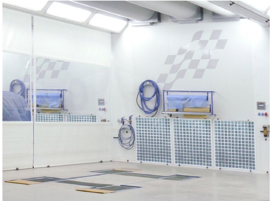
Abb. 5 Vorbereitungsplatz mit diagonaler Luftführung (senkrechte wandseitige Absaugung)
